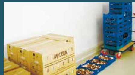
Wandverkleidung in Kühlraum
