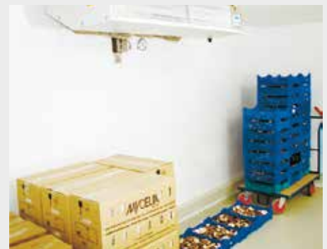
Wandverkleidung in Kühlraum
