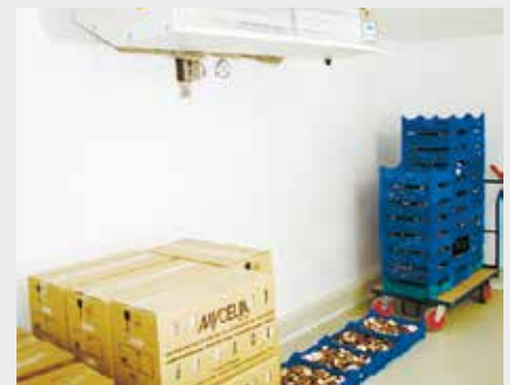
Wandverkleidung in Kühlraum
